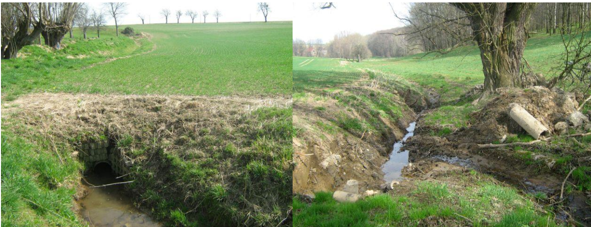
Abbildung 4: a) Verrohrter Bach unter Acker in Luga bei Meißen (links) b) Geöffnete Verrohrung oberhalb von Kaschka bei Meißen
