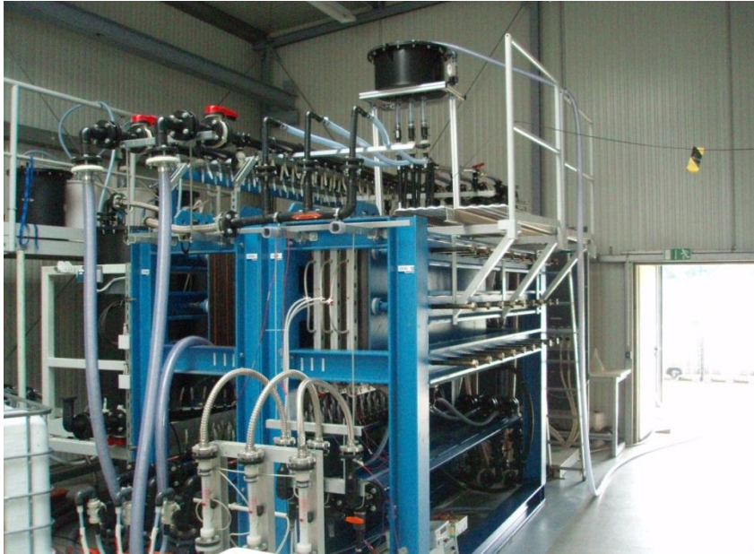
Abbildung 28: Elektrolyseanlage mit Spülkreislauf (Foto: VKTA 2013)
