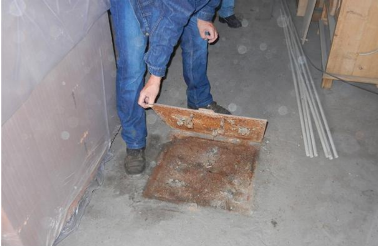
Abbildung 14: Kontrollöffnung des Vertrauen-Schachtes. Der Schacht ist vollständig verfüllt. (Foto: DMT Leipzig 2013)
