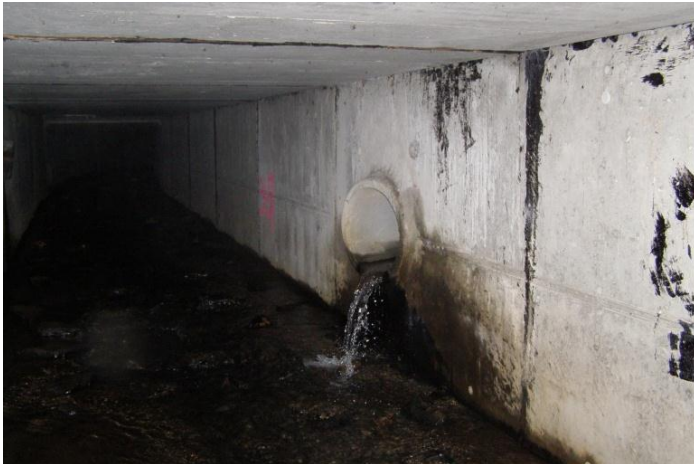
Abbildung 13: Regenwasserkanal mit Sickerwässern von der Deutschland-Schacht I-Halde in den Hegebach (Foto: Beak Consultants 2013)
