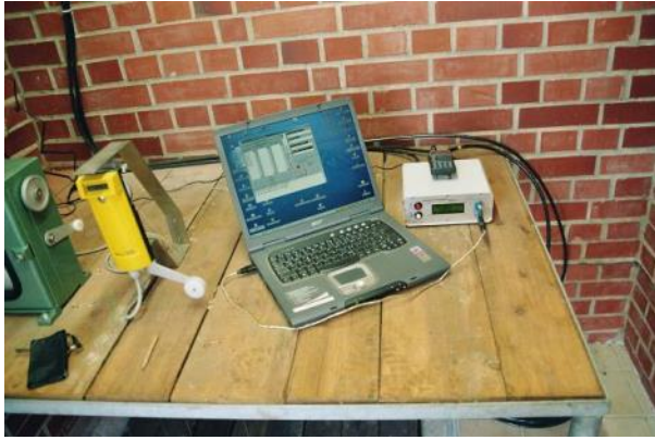
Abb. 72: Telemetrie-Station im Pegelhaus
