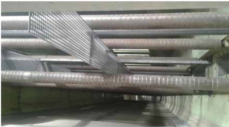
Abb. 14: Eingebaute Diffusorbleche in den Bandzwischenräumen eines Bandtrockners tschechischer Bauart
