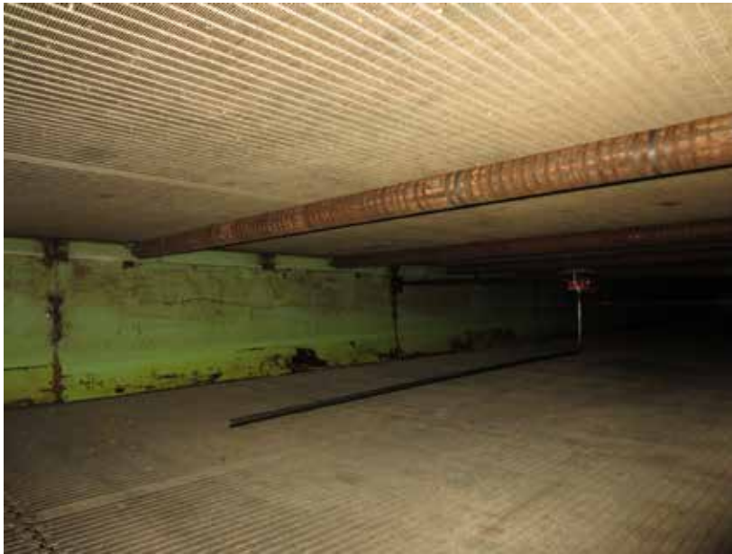
Abb. 62: Kapazitive Feuchtigkeitsmessung mittels einer Messlanze im Bandrockner
