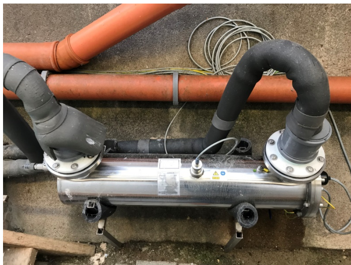
Abb. 17: UV-Rohrleitungsanlage zur Keimreduzierung des Wassers eines im Kreislaufbetriebenen Kaltwasserbruthauses für Lachseier. Der Zulauf wird über den rechten Flanschanschluss realisiert.
