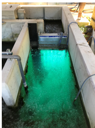
Abb. 13: Die UV-Offenkanalanlage in der Forellenbrutanlage. Oben links: Siebtrommelfilter mit Ablaufkanal bzw. Zulaufkanal zur UV-Einheit mit einer mittleren Tiefe von 7,5 cm. Im Vordergrund (=stromabwärts der UV-Einheit) findet eine Druckluftspeisung statt.
