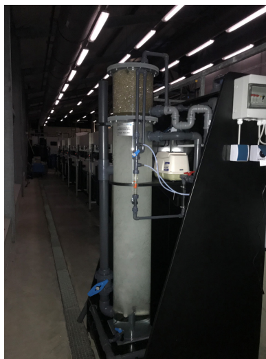
Abb. 9: Der mobile Süßwasserabschäumer inkl. Ozon-Einheit am Standort Hohen Wangelin.
