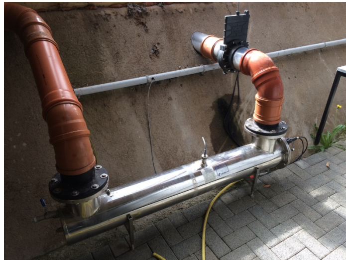
Abb. 20: UV-Rohrleitungsanlage zur Keimreduzierung des Wassers einer im einfachen Durchfluss betriebenen Rundbeckenanlage zur Lachsaufzucht. Der Zulauf wird über den rechten Flanschanschluss realisiert.
